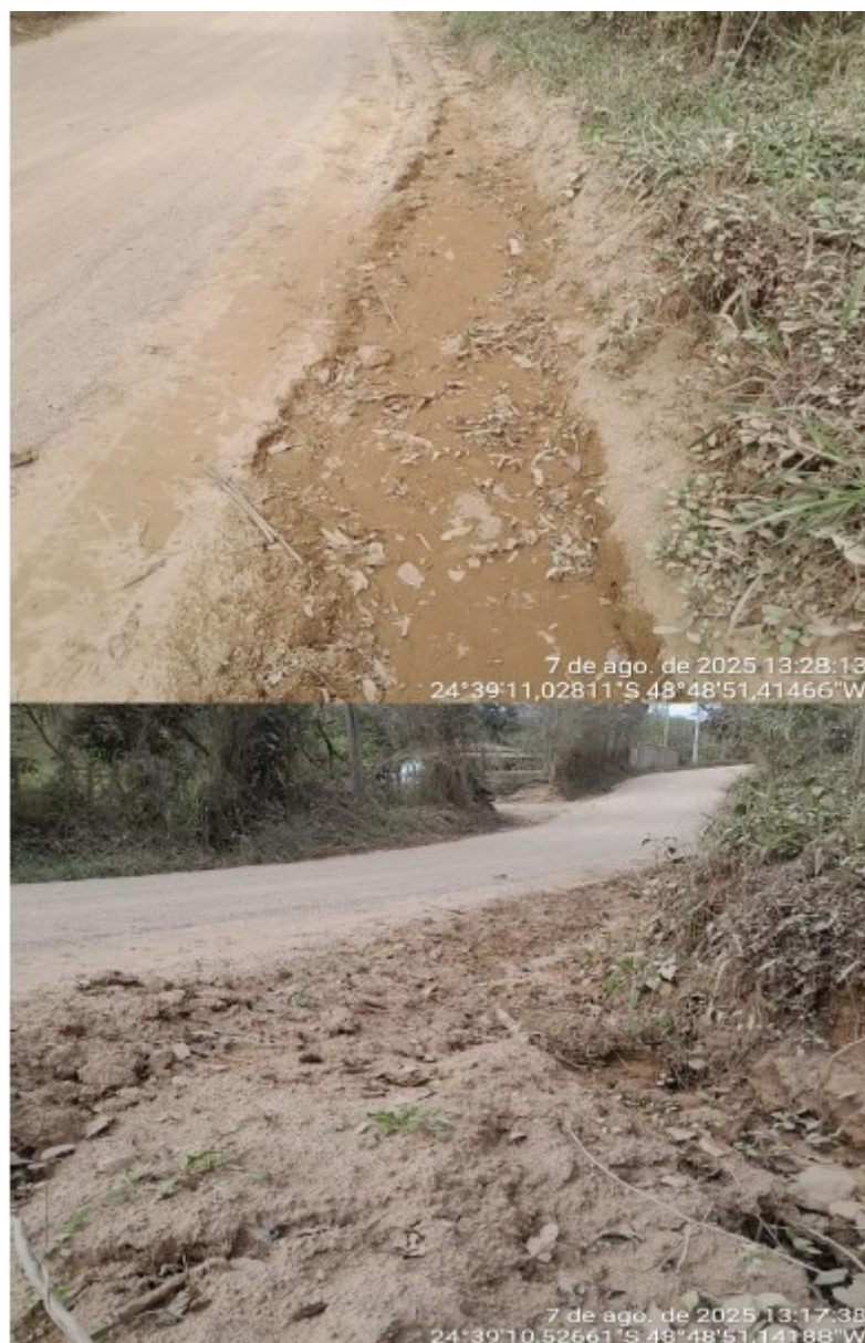
IMAGEM 3: Local na estrada da atual erosão
