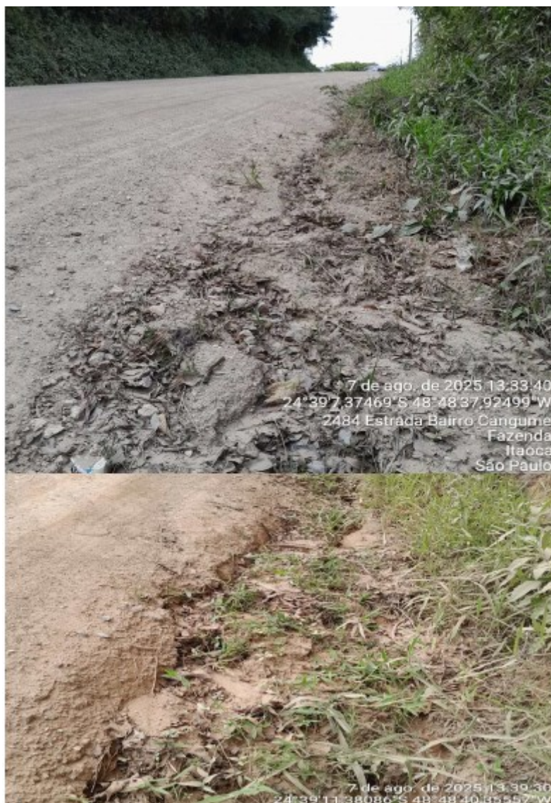
IMAGEM 2: Local na estrada da atual erosão
