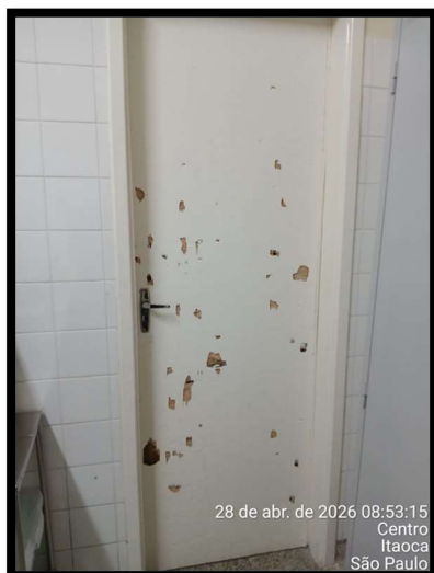
Foto 9: Detalhe de porta com elevado estágio de deterioração
