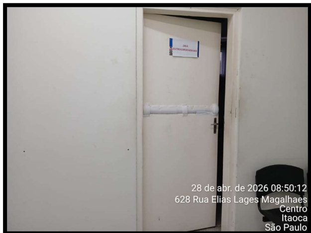
Foto 10: Detalhe de porta com elevado estágio de deterioração e que necessita de intervenção.
