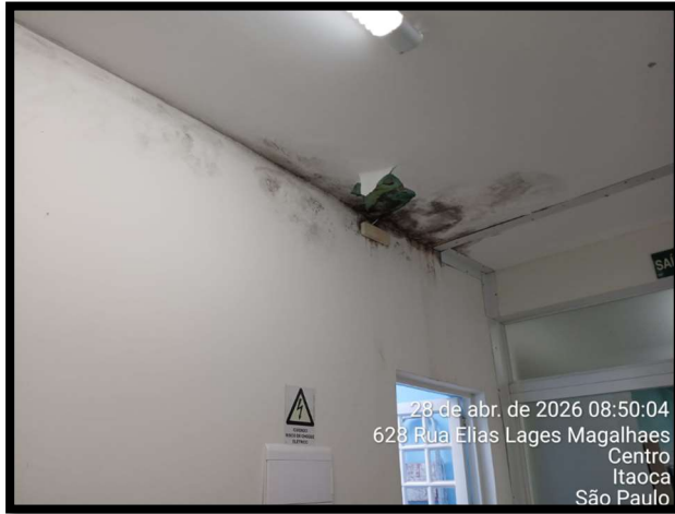
Foto 4: Corredor da área administrativa com proliferação de mofo
