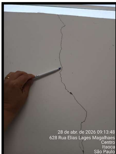
Foto 3: Detalhe das trincas encontradas
