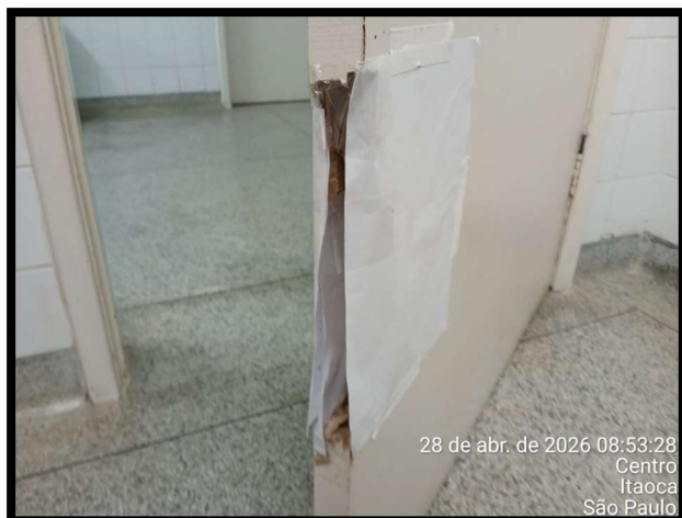
Foto 8: Detalhe de porta com elevado estágio de deterioração
