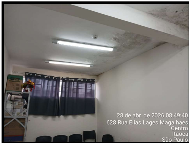
Foto 6: Forro em laje da sala de reuniões com proliferação de mofo
