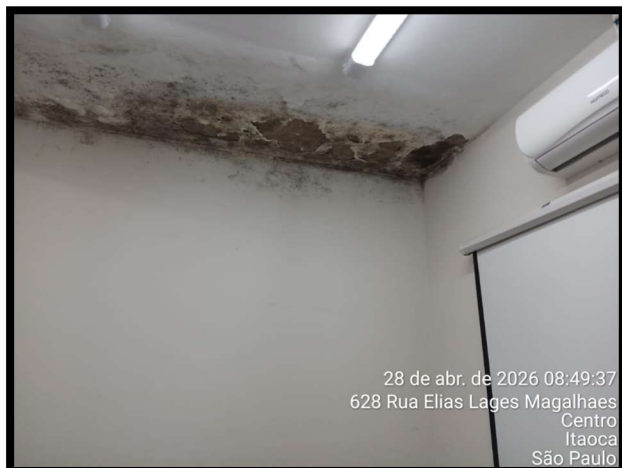
Foto 7: Forro em laje da sala de reuniões com proliferação de mofo
